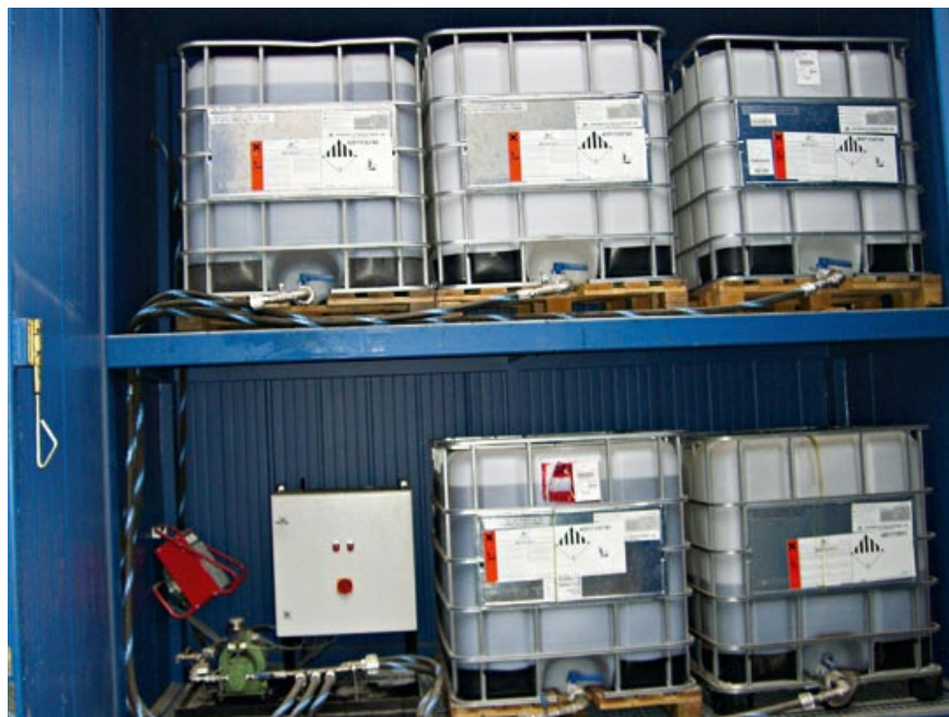
Bild 3: Installation der Dosierpumpe innerhalb des Regals
